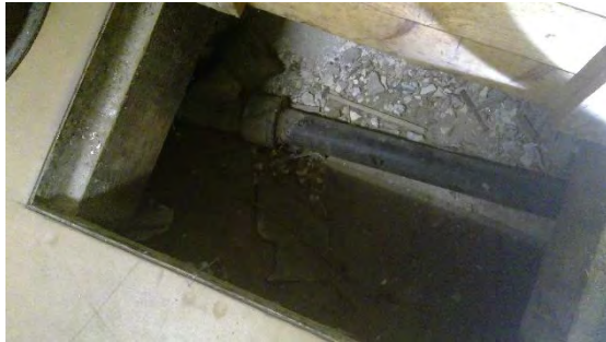
Foto voor Bron 4 Rioleringsbuis
