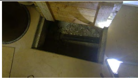
Foto voor Bron 4 Rioleringsbuis
