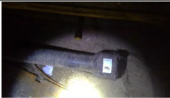
Foto voor Bron 4 Rioleringsbuis
