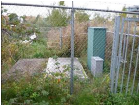
Figuur 3 Inlaat + gemaal Vinckebuurt naar Amstel
