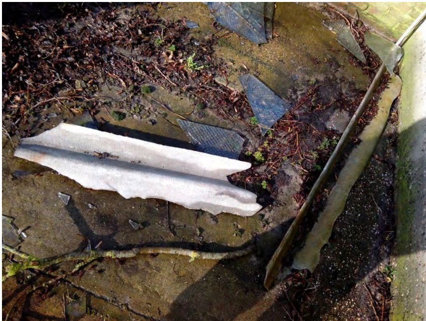
Figuur 2.3: Stukken asbest golfplaat op betonverharding
