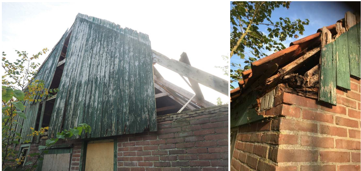
Figuur 5. Vervallen staat van de aanwezige bebouwingen daarmee ongeschikt als verblijfplaats voor vleermuizen.
