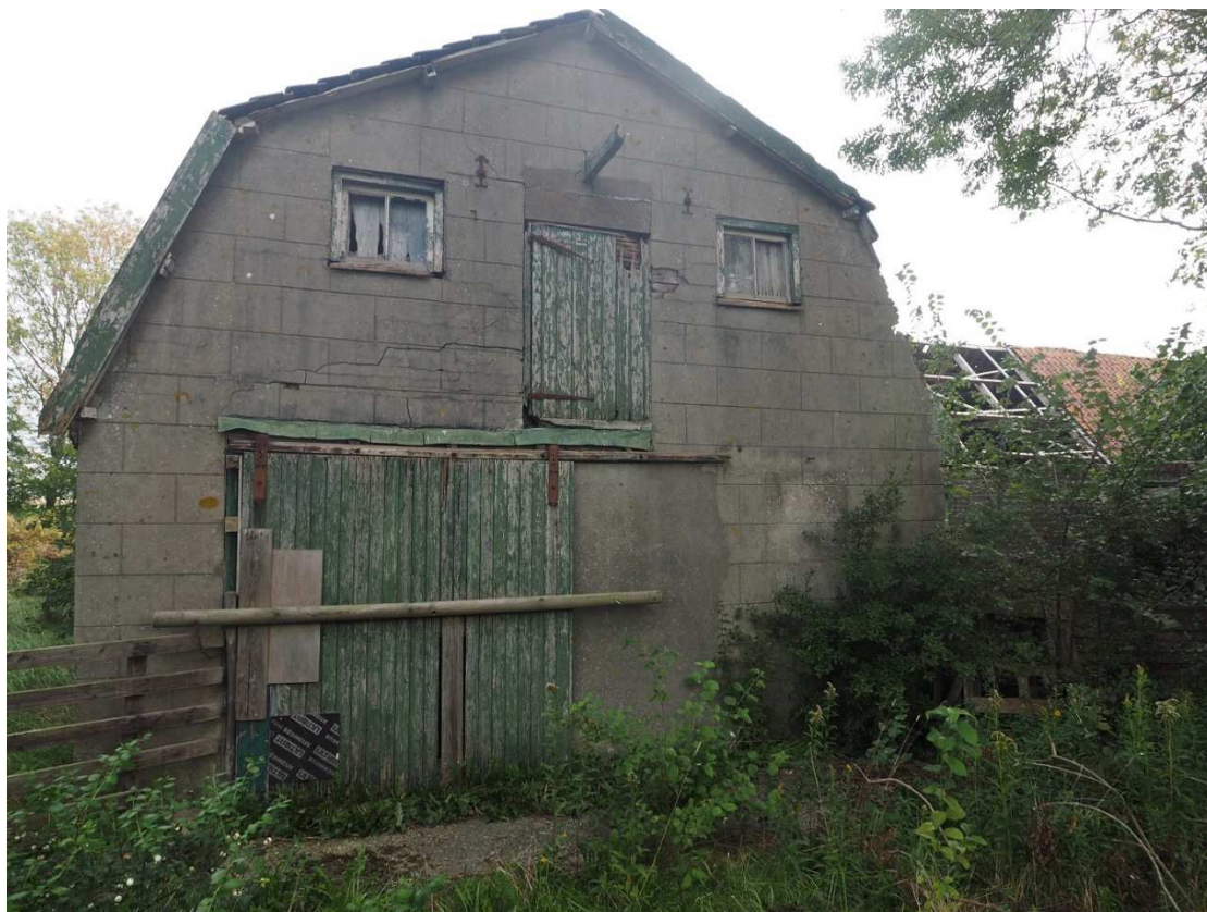
Figuur 3. Vervallen woonhuis met wolfskap met op achtergrond vervallen schuur met pannendak
