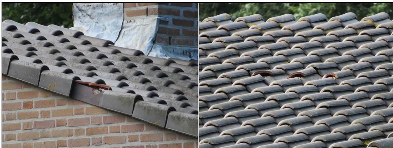
Afbeelding 9: Kapotte pannen in het plangebied en open stootvoegen boven loodslabben schoorsteen
