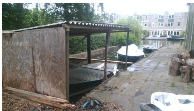
Figuur 8: Boothuis (asbestverdacht golfplaten dak)
