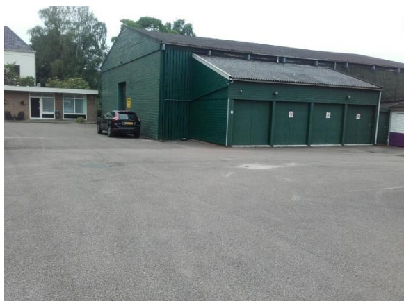
Figuur 7: Voormalige Houtloodsen (asbestverdacht golfplaten dak)
