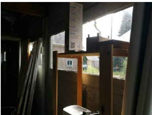
FB12: Tussen de kozijnen en de beglazing van dit deel van de garage is geen asbestverdachte kit waargenomen.
