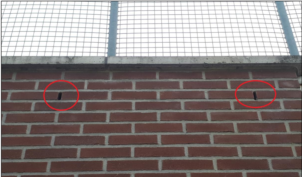
Figuur 2.2.: In het bedrijfsgebouw in het plangebied zijn spouwmuren aanwezig die mogelijk toegankelijk zijn voor vleermuizen door de aanwezigheid van stootvoegen.
