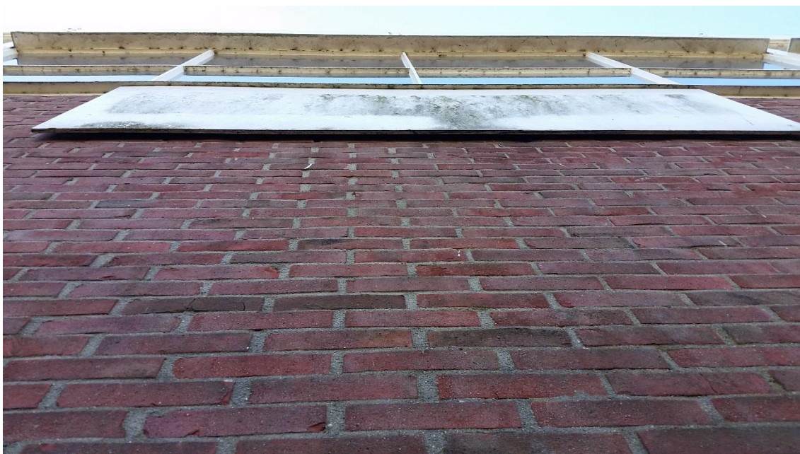
Foto 2. Beplating aan de muur van een bijgebouw. Achter de plaat kan een verblijfplaats van vleermuizen aanwezig zijn.
