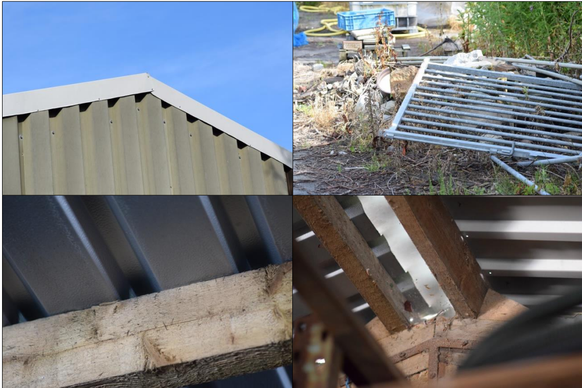
Foto's 3-6. Linksboven de nok van de schuur. Rechtsboven opgeslagen materialen rondom de schuur. Links- en rechtsonder de binnenzijde van het dak van de schuur
