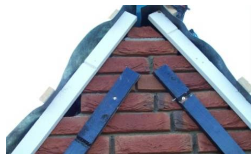
Figuur 3.2: Dit nieuwbouwproject in Blokzijl is vleermuisvriendelijk gebouwd. De spouw is hier via de kopgevel toegankelijk gemaakt via een uitsparing in een profiellat. Later is er een boeiplank overheen geplaatst. Foto: WetlandWonen
