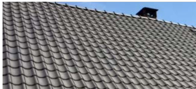
Voorbeeld van een dak met gesmoorde pannen
