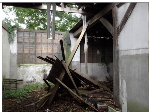
Foto 4: Enkele delen van het dak zijn geheel ingestort.
