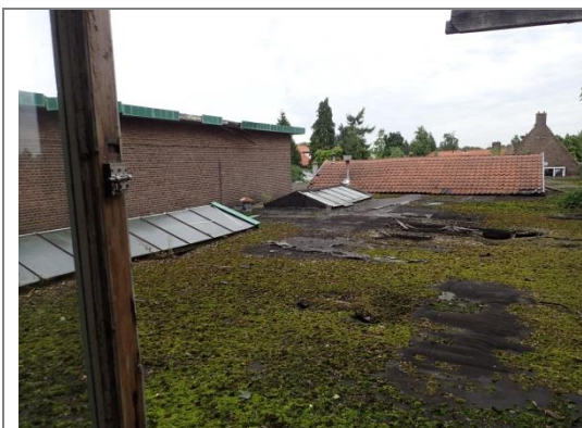
Foto 3: Het platte dak van het gebouw is rot en gedeeltelijk ingestort.
