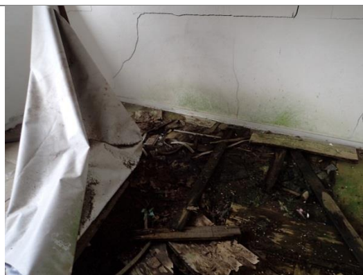
Foto 8: Op de verdieping is het meeste houtwerk aangetast door vocht, waardoor de muren beginnen te scheuren.
