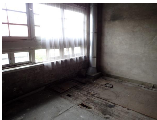
Foto 6: Op de verdieping zijn delen van de vloeren verrot door lekkage.
