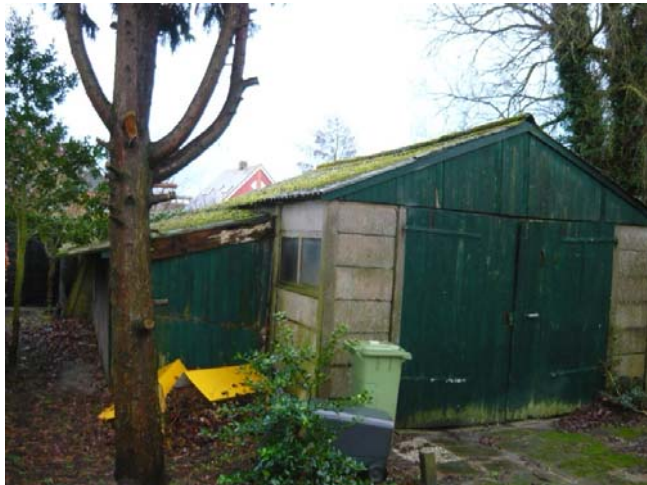
Foto 2: Schuur naast woning met dak van golfplaten van asbestverdacht materiaal.
