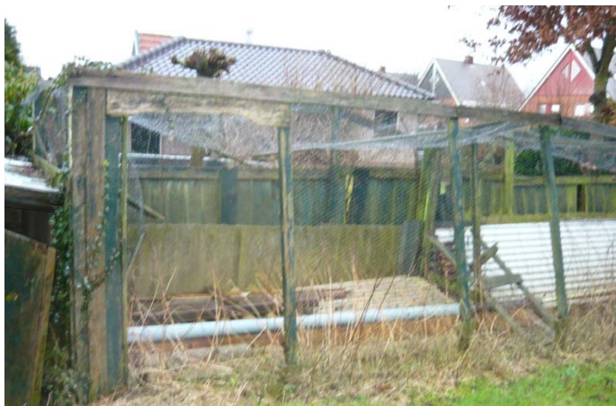
Foto 3: Hok met rechtopstaande schotten van asbestverdacht materiaal.
