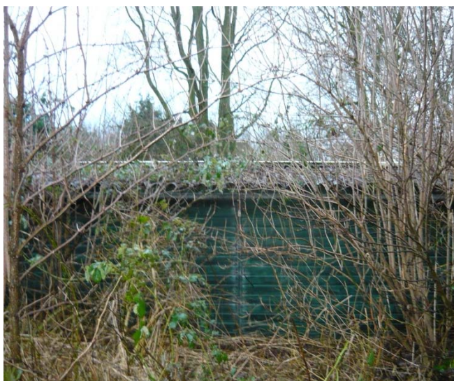
Foto 1: Schuur met dak van golfplaten van asbestverdacht materiaal.
