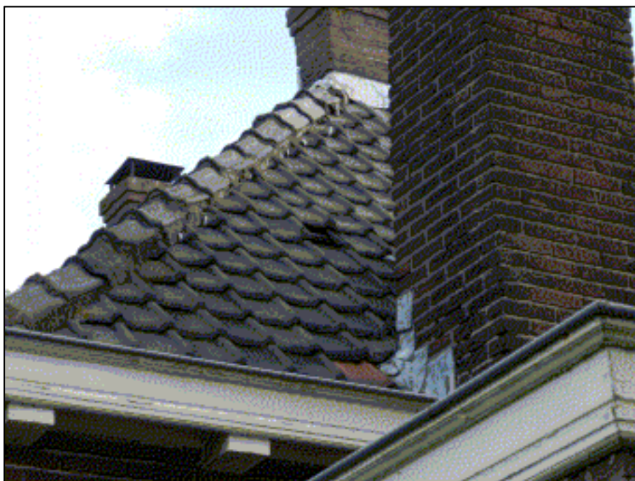
De holtes achter de gaten in het dak worden niet gebruikt door vleermuizen.
