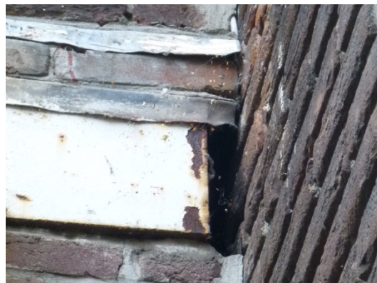
Gat tussen de gevel en de stalen draagbalk, groot genoeg om een huismus door te laten.
