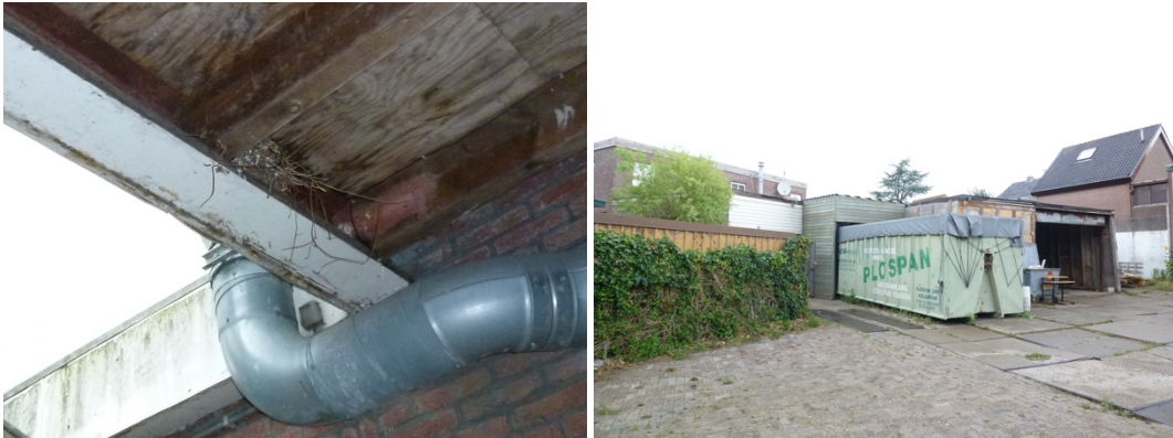
Links een nest van een Turkse tortel in de overhang aan de achterzijde van de bebouwing. Rechts de gebouwen in het noordoostelijke deel van het plangebied, waar vele mogelijkheden zijn voor vogels (en andere soortgroepen) om naar binnen te komen.
