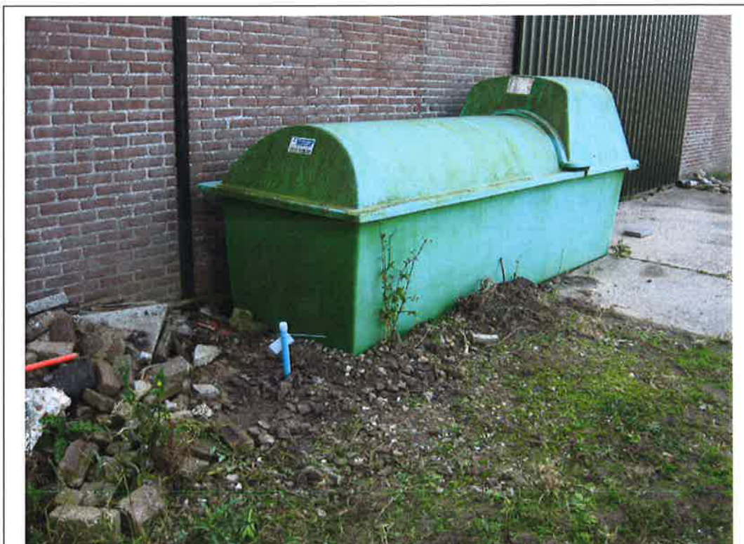
Foto 2: tpv bovengrondse tank peilbuis 14 (foto zuidelijk gericht)
