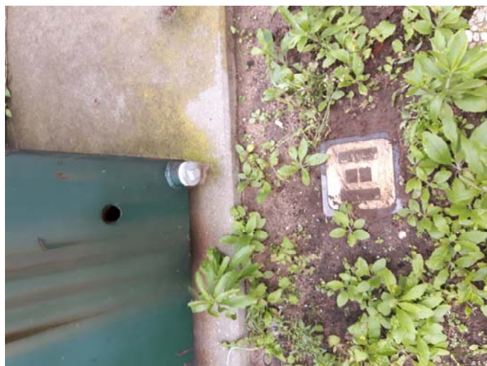
Foto 34: Noodstroomaggregaat met peilbuis 13 bij afvoerpunt
