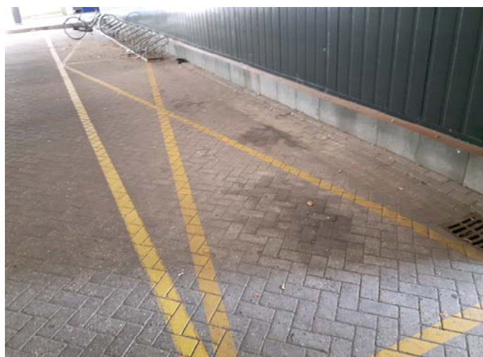
Foto 13: Olieplekken op verharding parkeergarage
