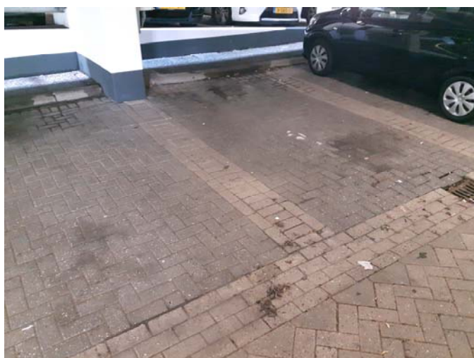
Foto 14: Olieplekken op verharding parkeergarage
