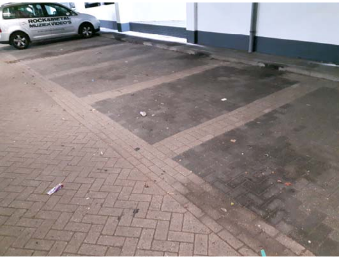
Foto 16: Olieplekken op verharding parkeergarage
