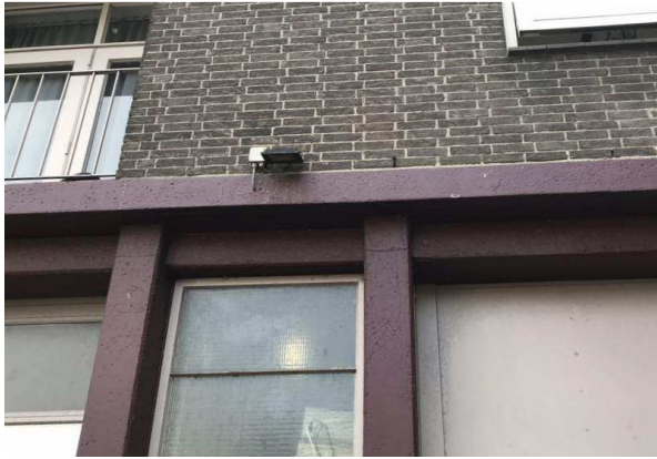
Figuur 14. Open stootvoegen in het gebouw in het centrum van het plangebied
