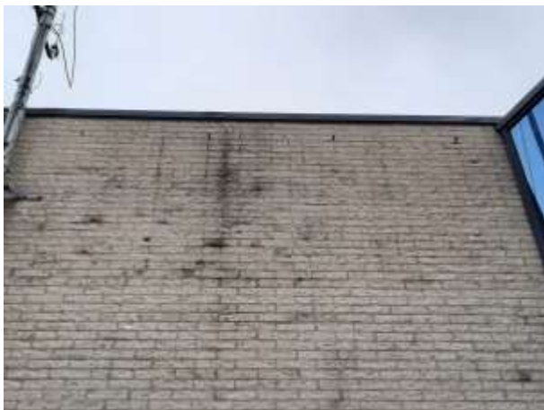
Detailopname van één van de buitengevels van het te slopen gebouw. Op de foto zijn open stootvoegen zichtbaar.
