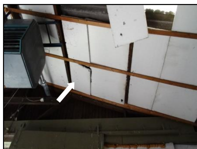
Figuur 12. Foto van de loshangende plafondplaten, locatie van de verblijfplaats van de kerkuil.
