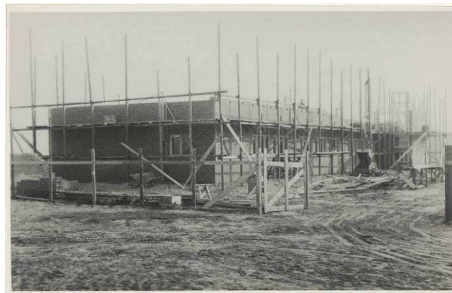
afb. 11 De 2 de Van Zeggelenschool aan de Anna Kaulbachstraat in aanbouw (bron: Noord-Hollands Archief, NL-HlmNHA_Hrlm_17742).
