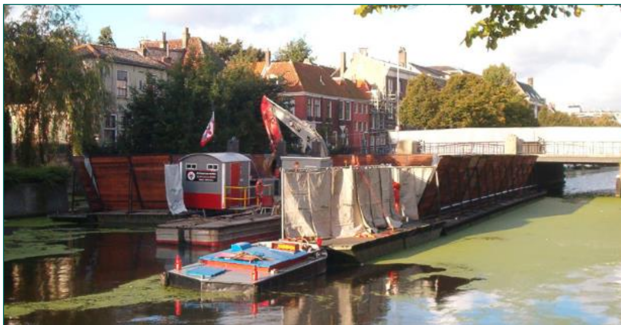
Figuur 127: Beveiligd baggerpontoon in Haarlem (Bron: REASeuro).
