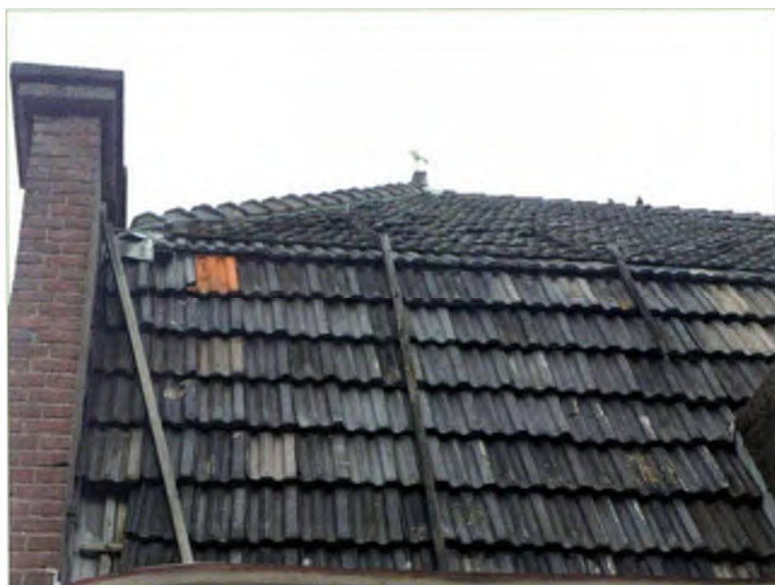
Gaten en spleten tussen dakpannen en tussen dakpannen en loodslabben kunnen toegang geven tot holtes die worden gebruikt door (jaarrond) beschermde vogels of vleermuizen.
