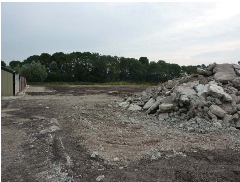
Afb. 1.2. Puinresten van de gesloopte manege in het noorden van het plangebied.
