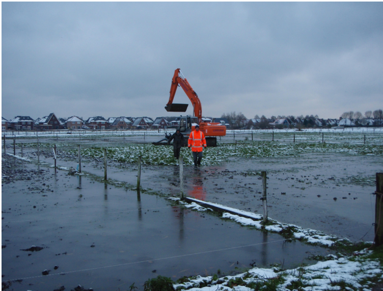
Afb. 2.2. Water op het maaiveld.
