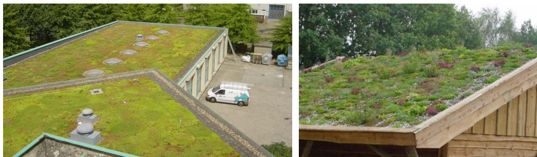
Figuur 4: Groene daken (links met mos-sedum en rechts met sedum-mos-kruiden)
