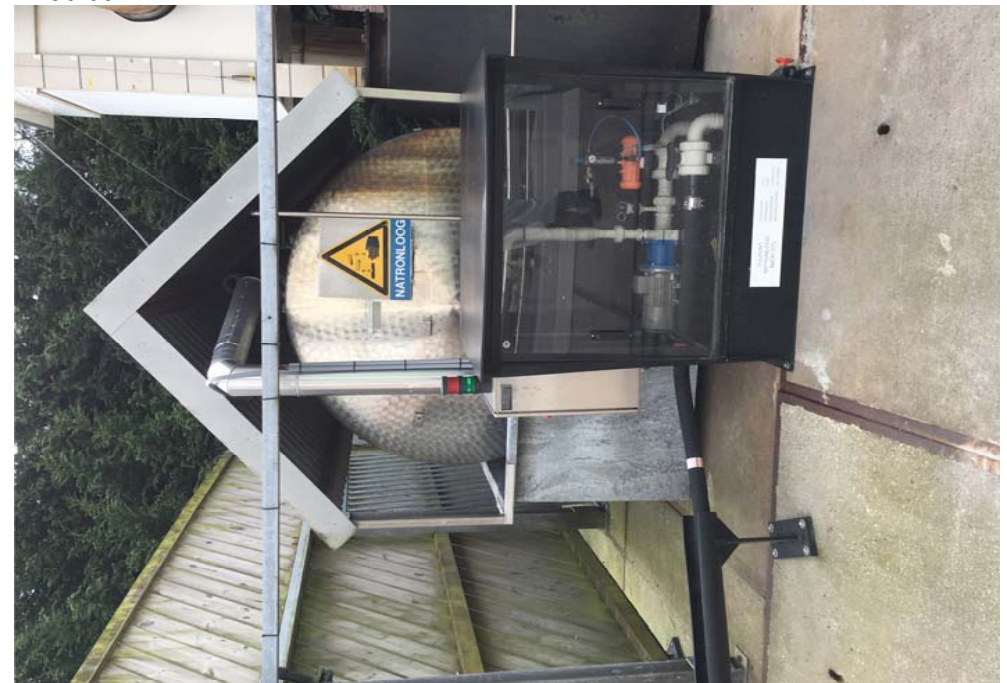
Natronloogtank (thv boring 111 en peilbuis 112)
