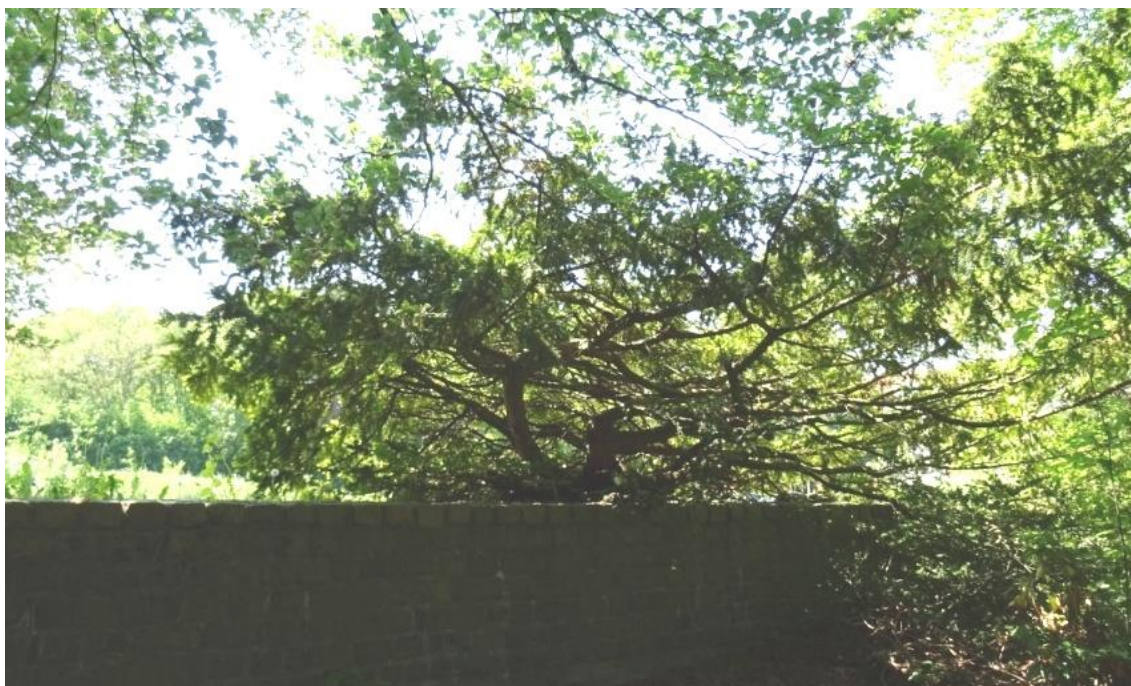
In de muur aan de oostzijde van het terrein groeien twee venijnbomen met een sterk afgeplatte groeivorm
