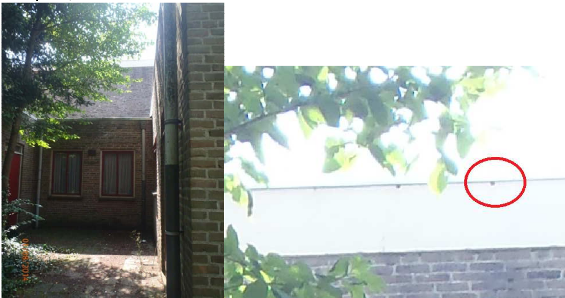
Afbeelding 7. De achtergevel heeft gaten in de daklijst als mogelijke invliegopening voor vlemuizen (rechts een detailopname)
