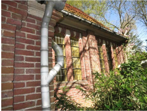
22. Noordelijk deel van de oostgevel van de vroeg 20e-eeuwse hobbyruimte-consistorie met in beide teruggelegen gevelvelden drie gekoppelde vensters met geblokte, gebogen bovendorpels en glas-in-lood.
