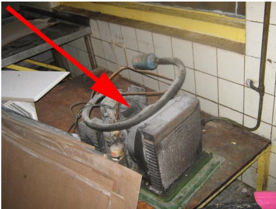
foto: 4, airco unit (onderdelen)
