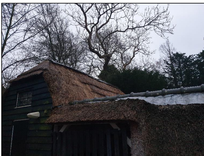
Rietkap met gaten door achterstallig onderhoud.
