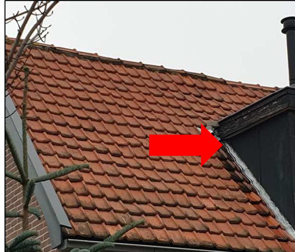
Afgesloten pannen. Alleen bij dakkappel zijn enkele kieren zichtbaar.
