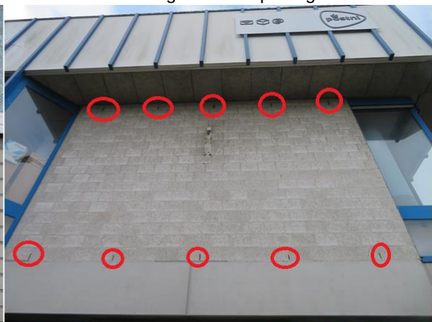
De enige open stootvoegen in het Postnl gebouw.
