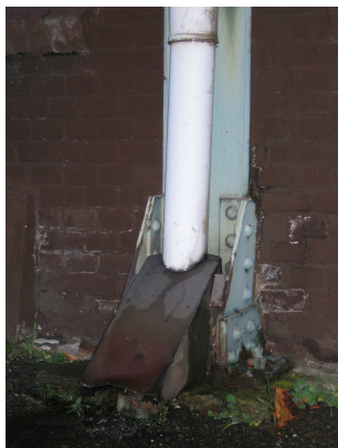
Figuur 8: Hemelwaterafvoer van de Kromhouthal (voormalig Stork terrein). De neerslag wordt via een pijp van het dak naar de straat geleid, waar het verdwijnt in een straatkolk.
