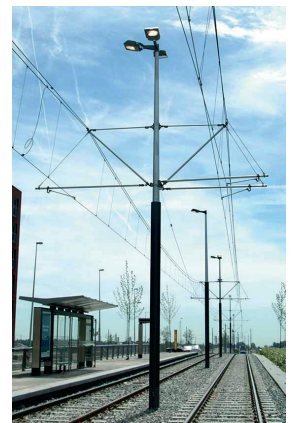
NPK-mast en -armatuur
