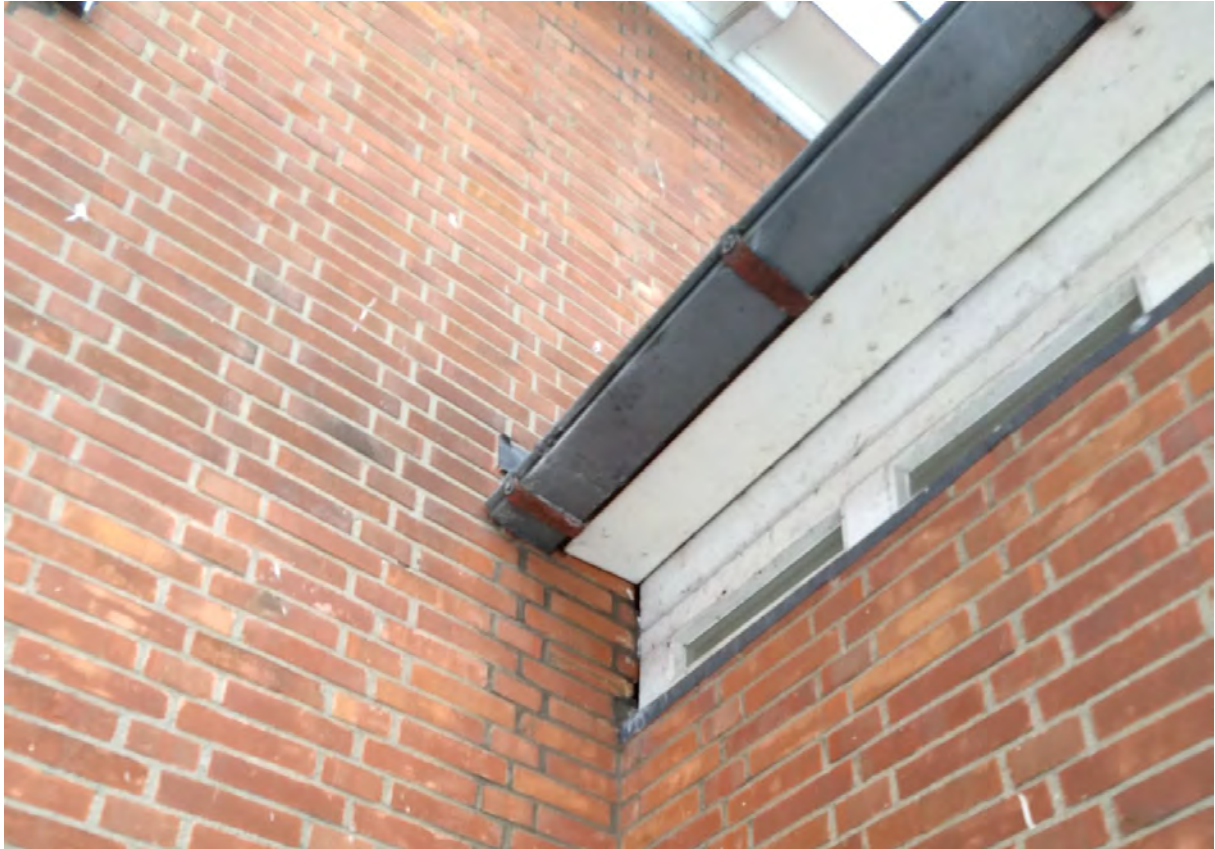
figuur 13: opening in de hoek, geschikt voor vleermuizen, gierzwaluwen, huismussen.
