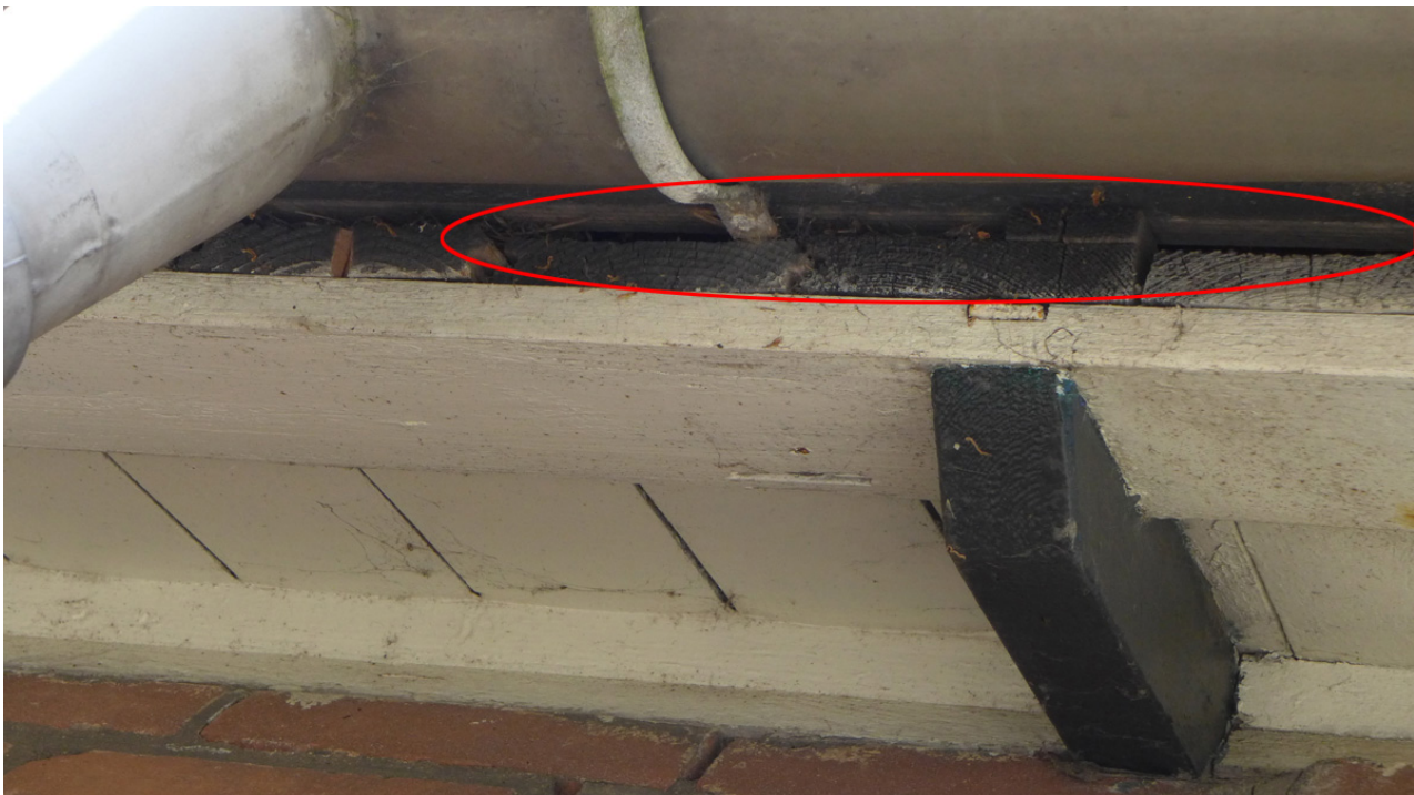
Afb.3: Kieren tussen het houtwerk waar vleermuizen tussen kunnen kruipen om tussen het dak te komen.
