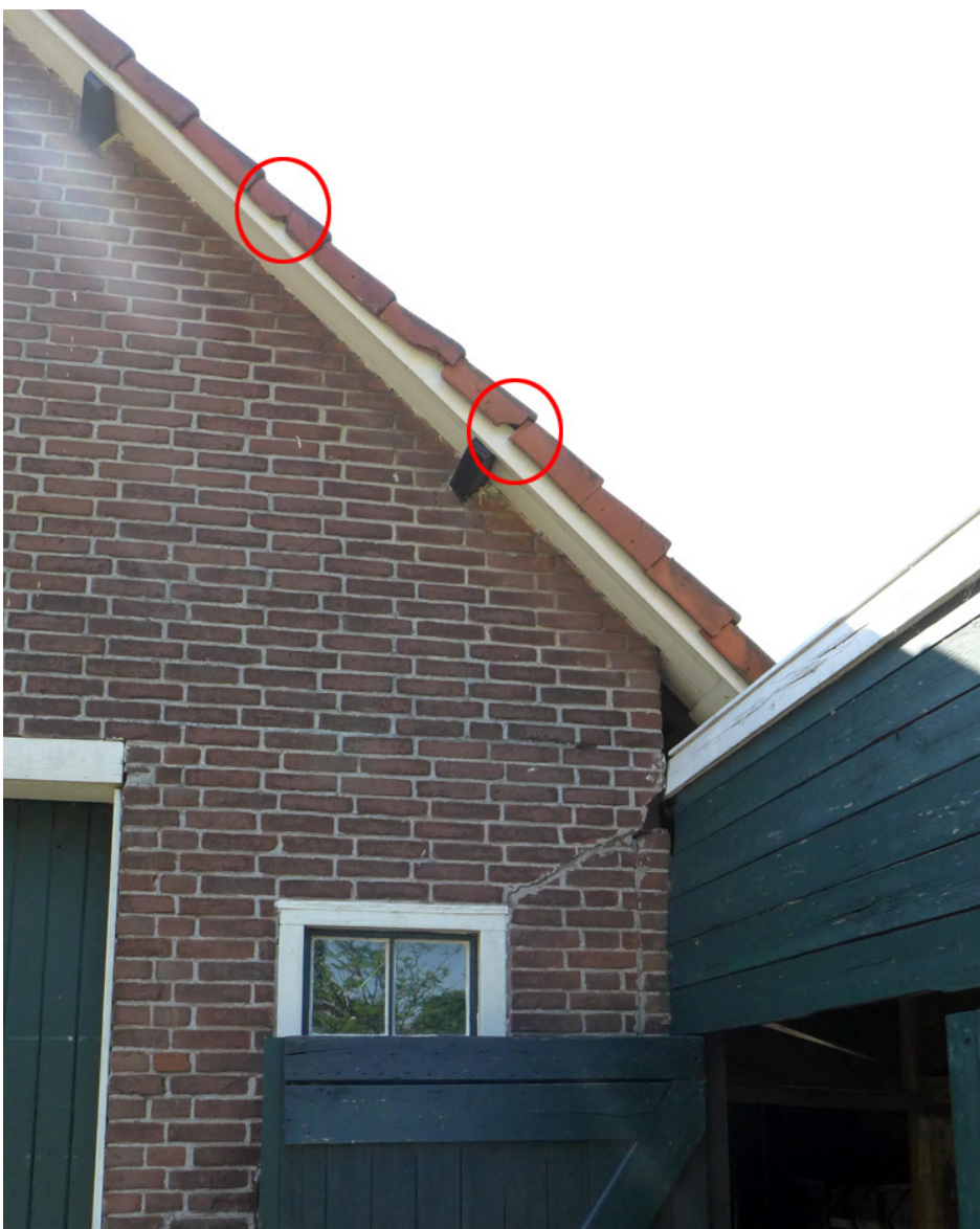
Afb.4: Gaten in de dakpannen waar vleermuizen tussen kunnen kruipen.
