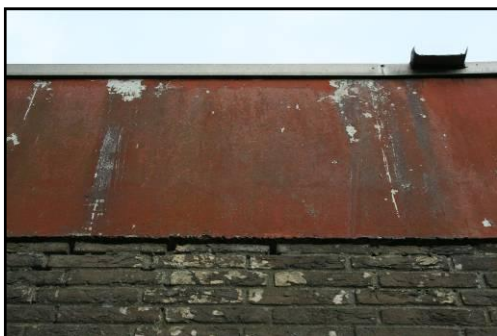
Foto 5: Daklijsten en open stootvoegen
