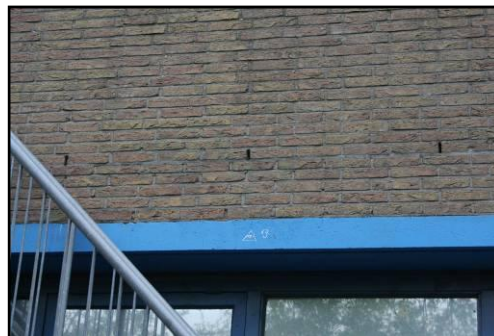
Foto 6: Open stootvoegen in spouwmuur
