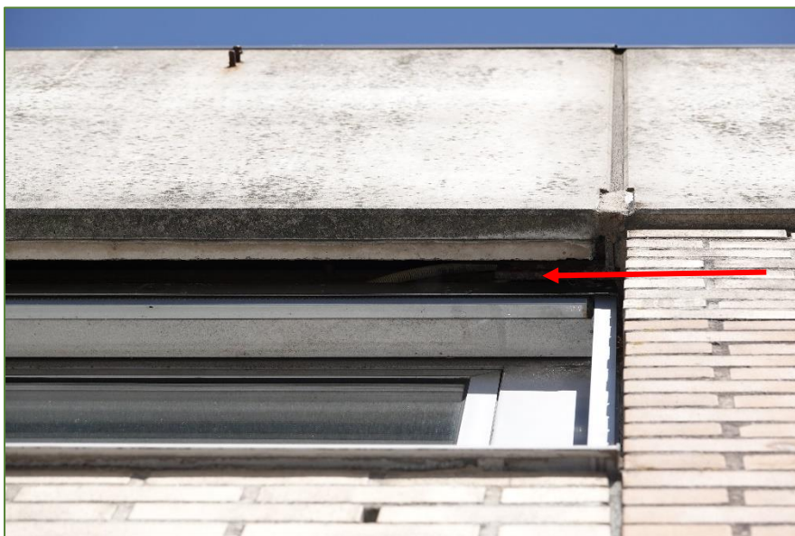
Figuur 4 Aan de voorzijde zijn ruimtes onder de betonnen wandbekleding aanwezig.
