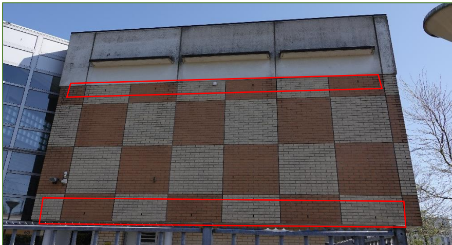
Figuur 3 Open stootvoegen op verschillende hoogtes in het voorste deel van het bedrijfspand.
