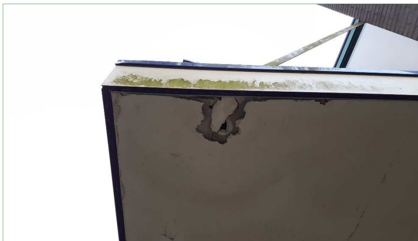
Gat in een afdak aan de oostzijde van het gebouw.
