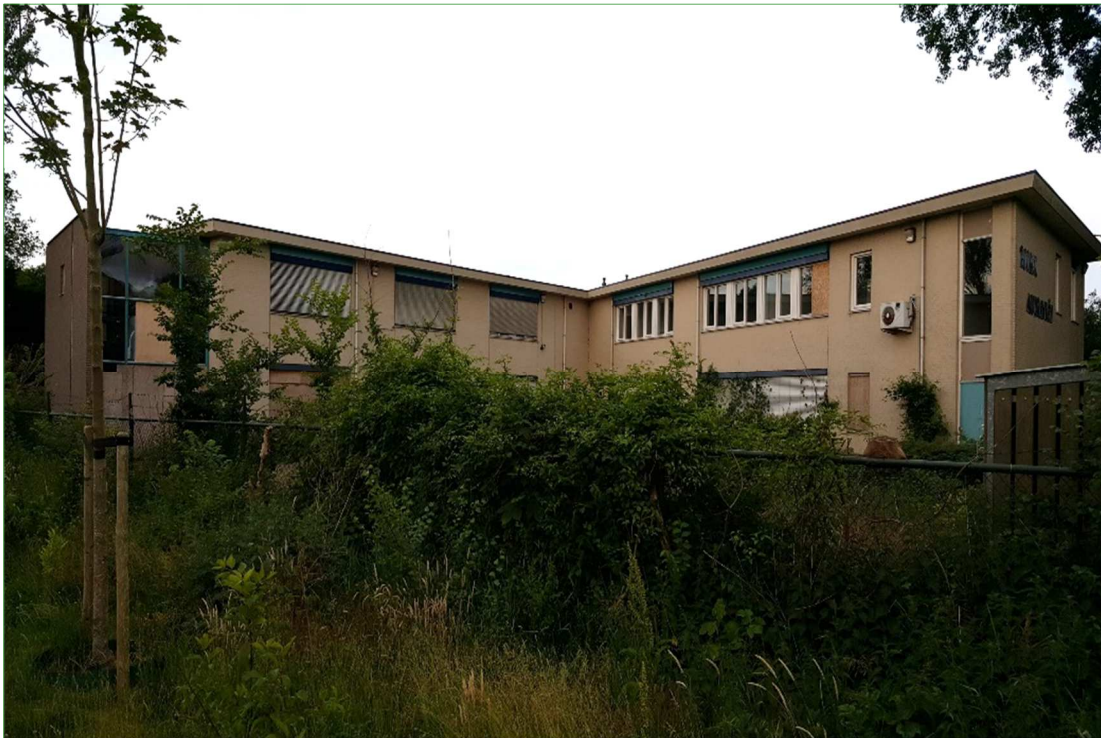
Kantoorpand met plat dak en veel open stootvoegen in de muren.
