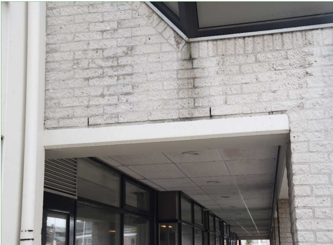
Smalle spouwopeningen boven de kozijnen geven mogelijk toegang aan dwergvleermuizen tot geschikte spouwholtes.
