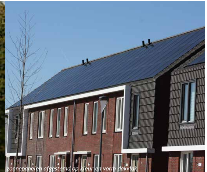
zonnepanelen afgestemd op kleur en vorm dakvlak
