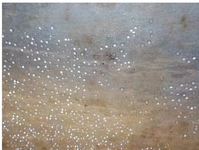
Foto 10 (condensvorming aan plafond)
