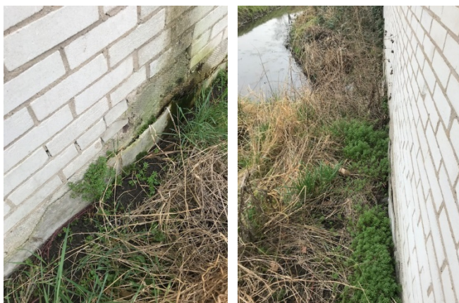
Asbest langs fundering tegen pand RE2
