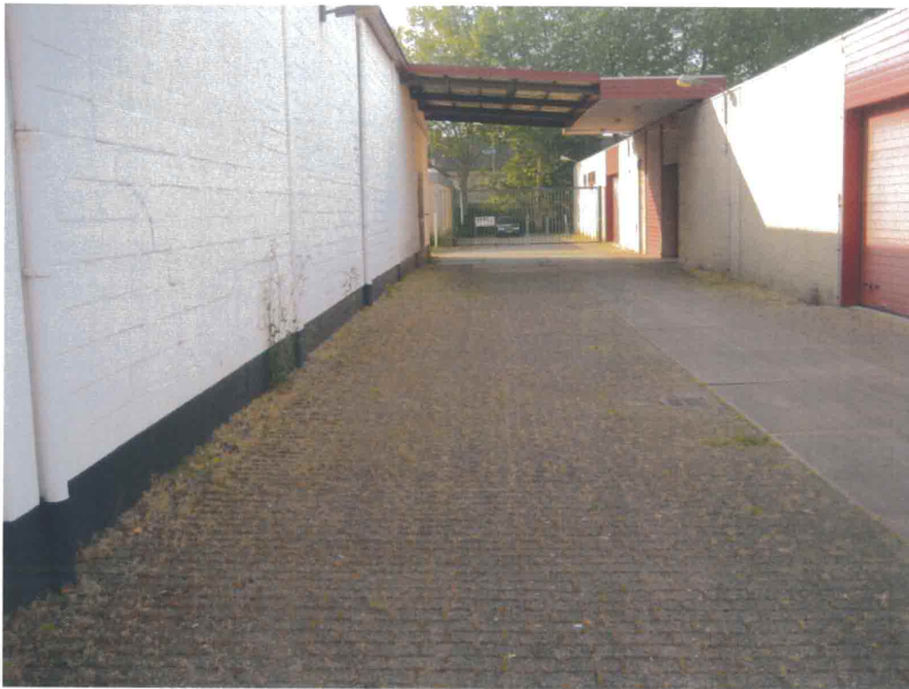
Foto 1: erfverharding ter hoogte van asbestverontreinigde puinverharding
