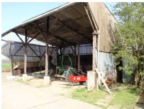
Afbeelding 6: gedeeltelijk ingestorte kapschuur met asbest op maaiveld
