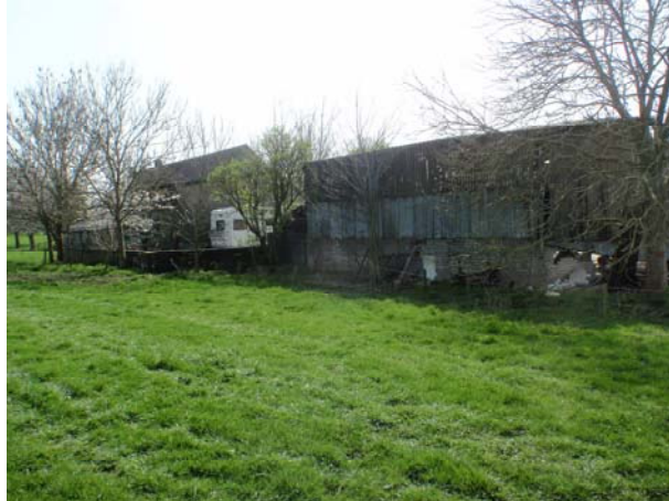
Afbeelding 10: achterzijde ingestorte kapschuur
