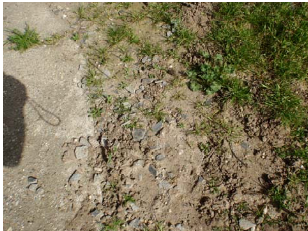
Afbeelding 11: asbest op maaiveld bij kapschuur
