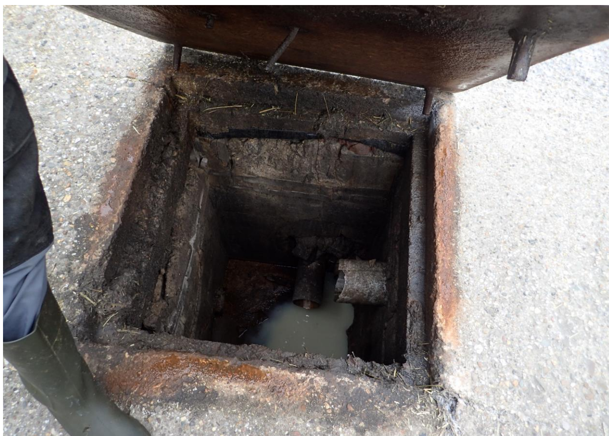
Putten en drains onder het erf. Er zijn veel maatregelen genomen vanwege wateroverlast en afvoer.
