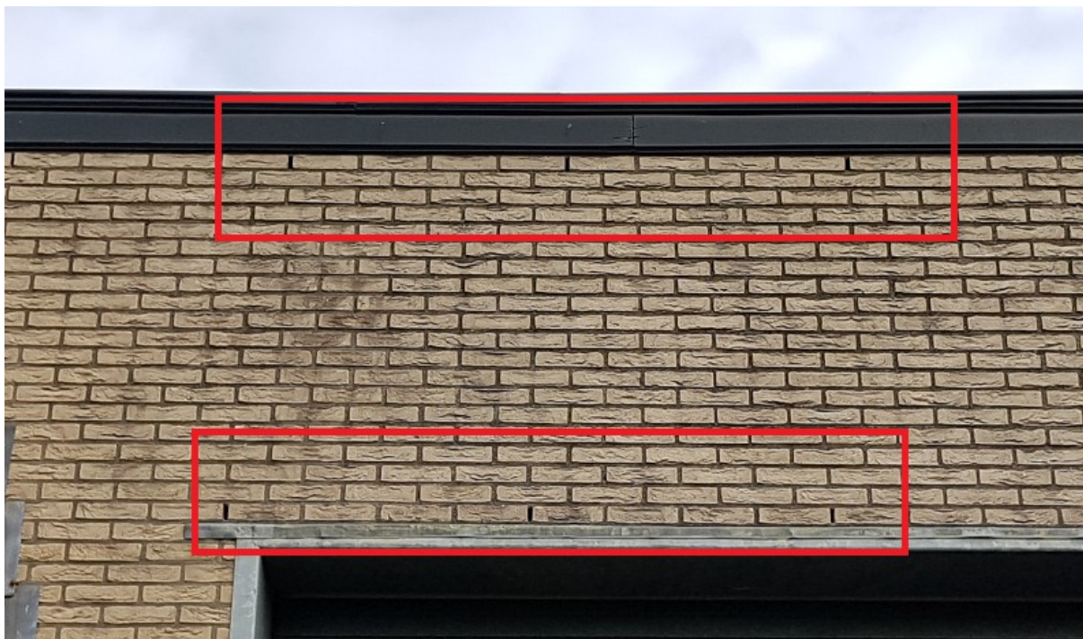
Afbeelding 5: Gevel met open stootvoegen in de rode kaders. Foto: B. Verhoeven | Ecoresult B.V.
